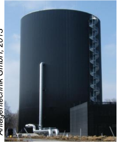
Source: Bilfinger VAM Anlagentechnik GmbH, 2013
