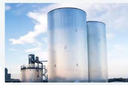
Wien: 2 x 5.500 m 3 Bildquelle: Wien Energie
